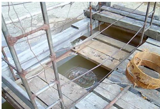
Fig. 7 Sistem de evacuare a apei limpezite
